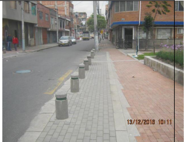
Foto 4. Pavimento Articulado: Se evidencian ahuellamientos adoquín en concreto
